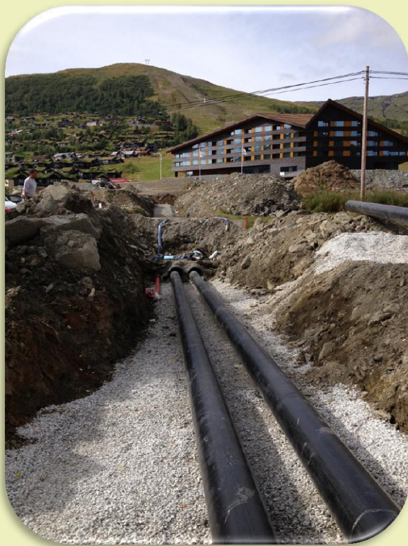
Fjernvarmeledning frå varmesentral til Myrkdalen hotell Foto: Voss Energi AS
